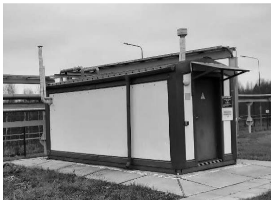
Рис. 1. Узел подогрева и дозирования
