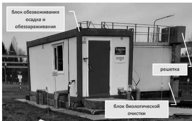
Рис. 2. Очистные сооружения биологической очистки «КСкомплект-1-36Ф»
