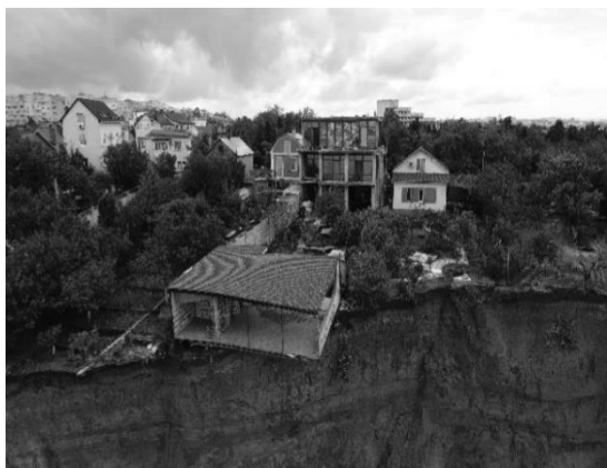
Рис. 1. Обвал грунта на территории
